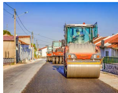
Die ersten Verdichtungsübergänge erfolgten mit der Tandemwalze HD+ 110i von Hamm. Zwei Gummiradwalzen GRW 18 nehmen Endverdichtung und Versiegelung vor. Bildquelle: Wirtgen Group
