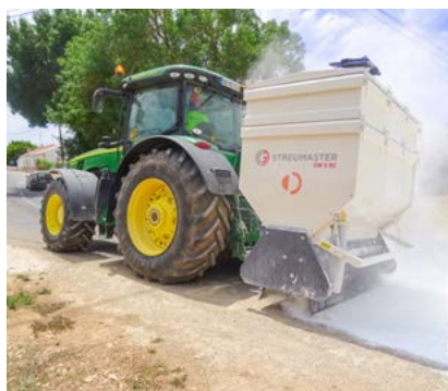
Der heckmontierte Bindemittelstreuer SW 5 RC verteilt präzise die erforderliche Menge Kalk vor dem Kaltrecycling-Zug. Bildquelle: Wirtgen Group
